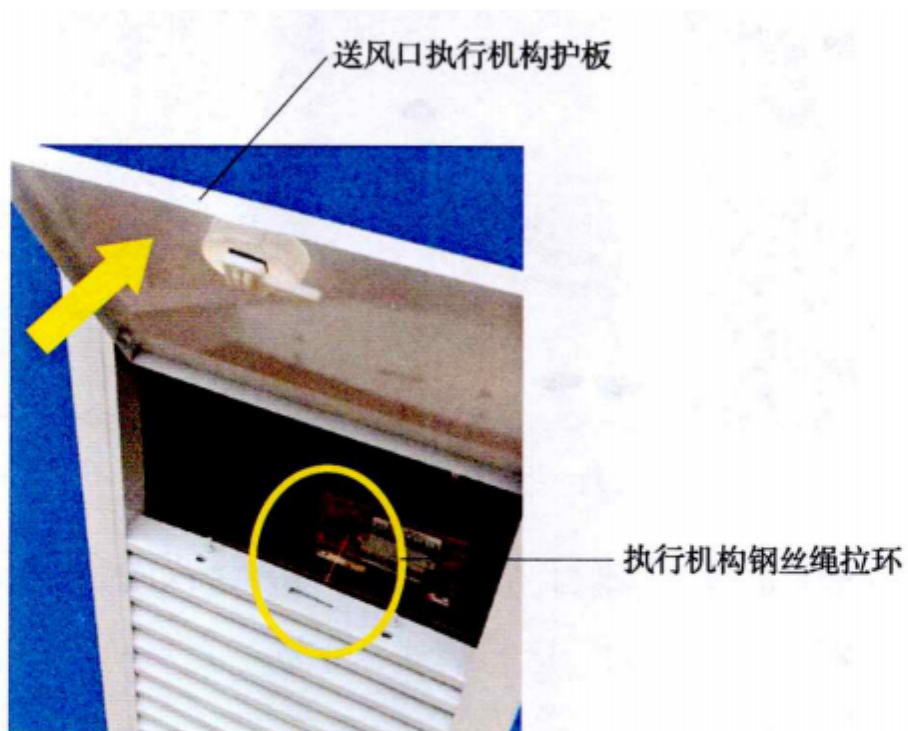
图 2-3-22 送风口现场手动操作示例
