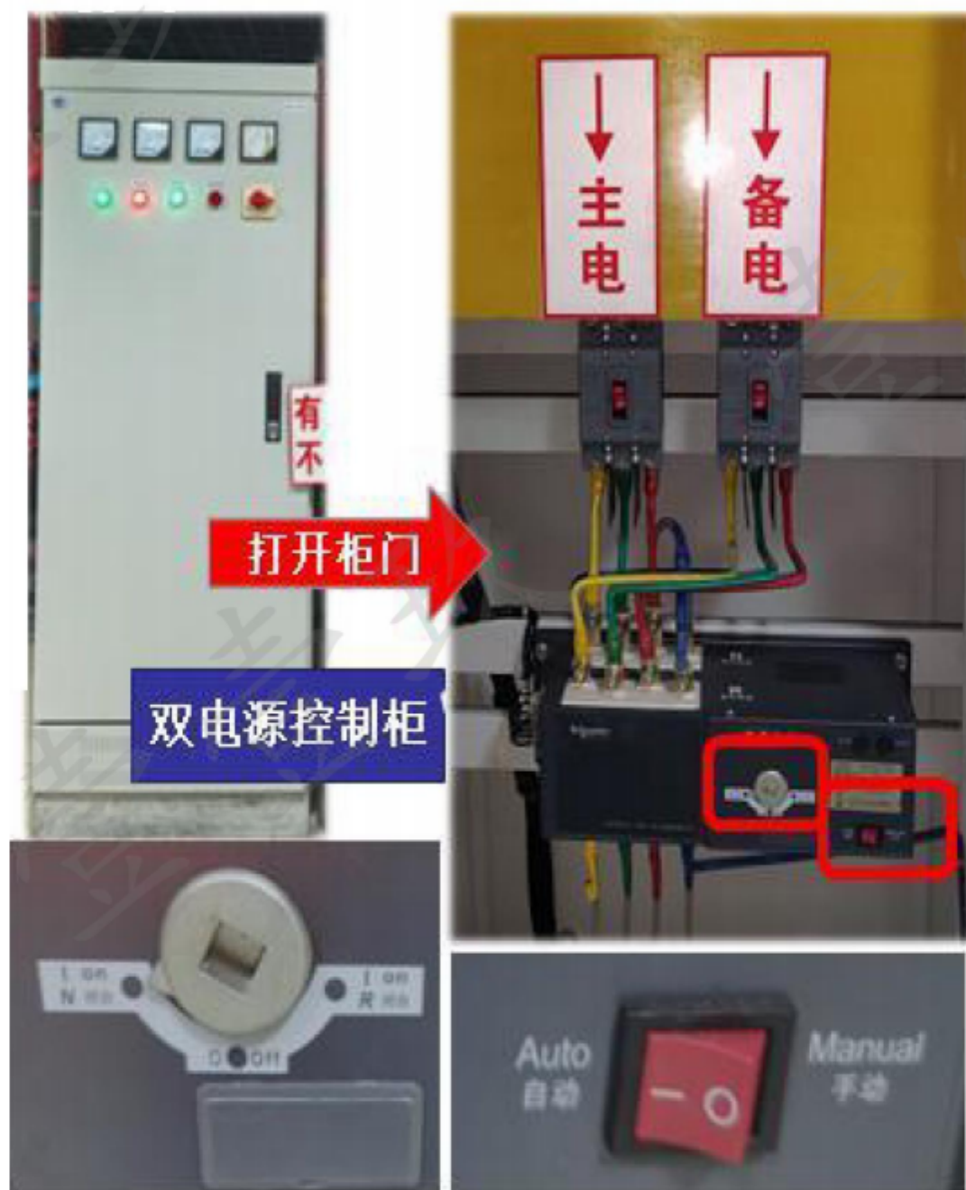
鉴定点三：增压稳压泵组电气控制柜操作（2分）
